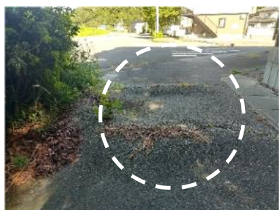
写真 4-2 歩道の根上り状況
