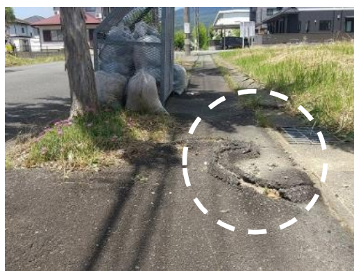
( 根上りにより通行に支障のある事例 )
