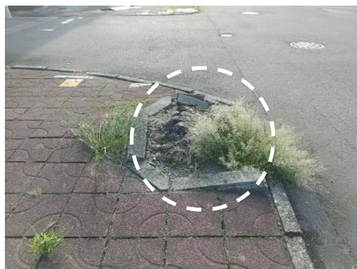
( 街路樹撤去後に植樹枠が存置されている事例 )
