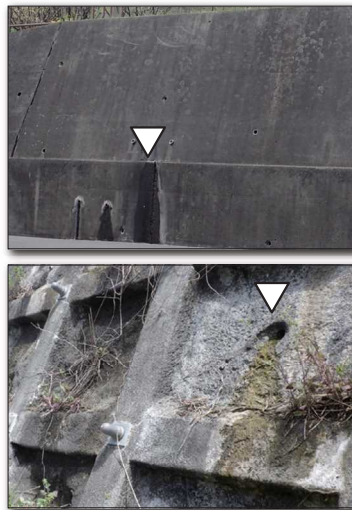
地下水の流出
