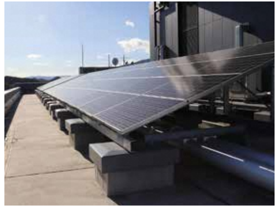
いわき市医療センターの太陽光発電
