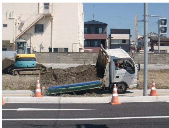
写真 老朽化した管きよによる陥没事故の状況 (平成28年度 小名浜地区)
