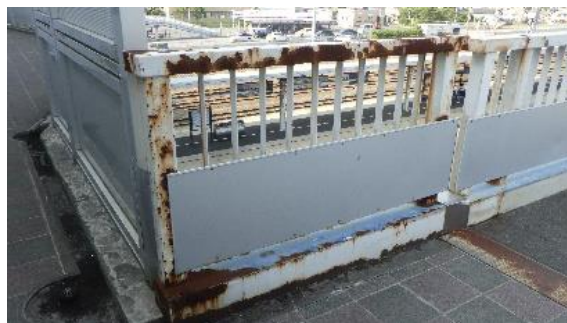
写真 泉駅自由通路 腐食による板厚減少
