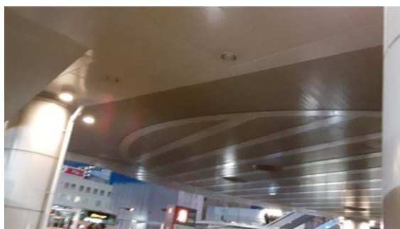
写真 いわき駅前ペDESTロリアンデッキ 照明設備の不具合
