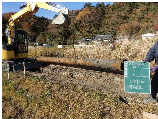
写真 老朽管の状況
