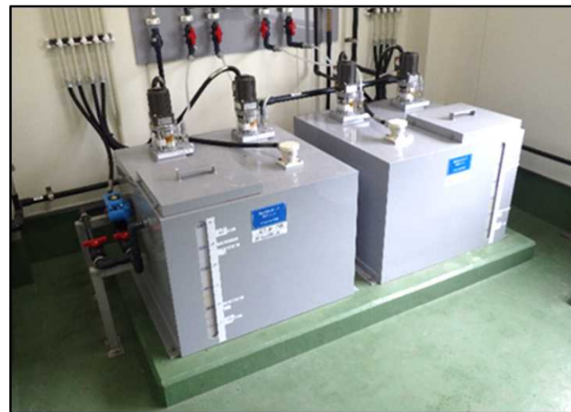
写真 追加塩素注入設備 平第2配水池
