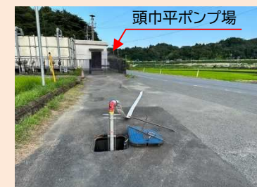
消火栓から給水を可能とした様子
