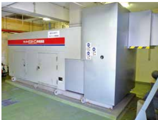
(再掲) 図 35 上野原浄水場の非常用自家発電設備
