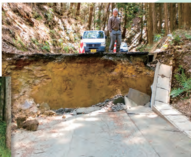
▶ 2-1 誘発地震で塩ノ平断層が動き、被災した市道大平・戸草線〔平成 23(2011) 年 4 月 13 日 いわき市撮影〕
