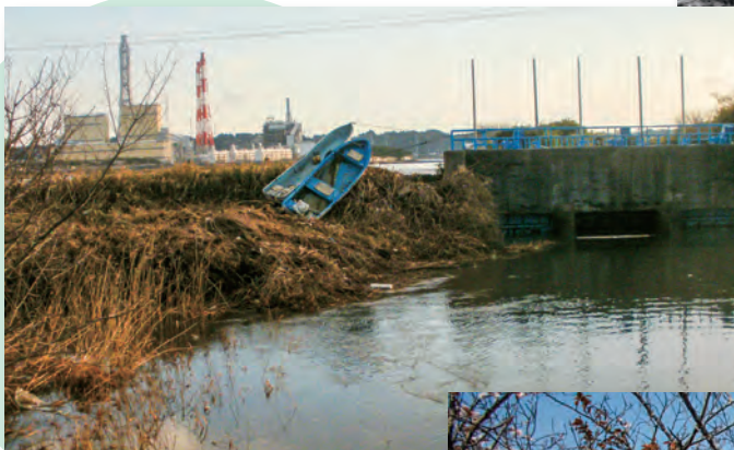
▲ 10-2 東日本大震災の大津波で被災した中田川水門〔平成 23(2011) 年 3 月 12 日 門馬俊次氏撮影〕
