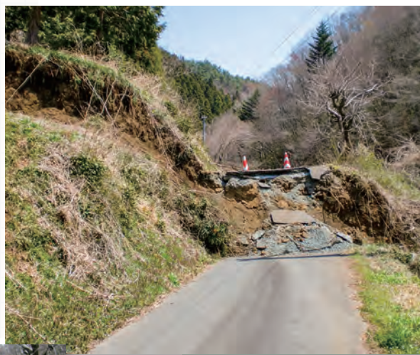
▲ 1-1 誘発地震で塩ノ平断層が動き、林道が2 m前後の落差で寸断・田人町黒田字塩ノ平〔平成 23(2011) 年 4 月 いわき市撮影〕
