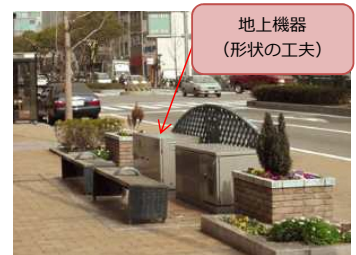
地上機器の工夫事例（神戸市）
