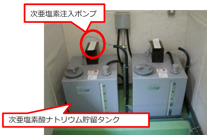
追加塩素注入設備（藤原ポンプ場内）
