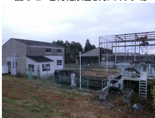
図 5-2 老朽化が進む芳川ポンプ場
