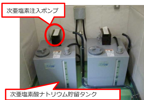
追加塩素注入設備（藤原ポンプ場内）
