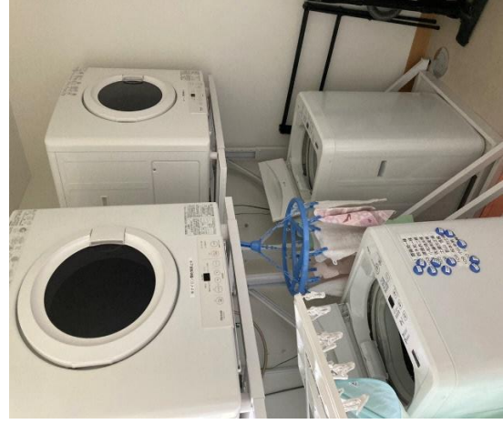
処理室 (洗濯機2台、乾燥機2台)
