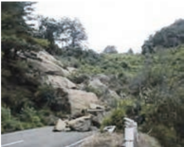
写真5-5 内郷内町地内の市道宮沢－蛭内線（復旧前） 斜面が大きく崩落し、復旧工事に時間を要するため通行止めとなった。 〔いわき市撮影〕
