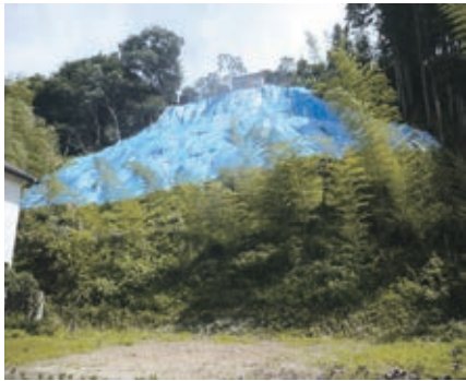
写真4-87 内郷内町駒谷地内の被害地 ブルーシートが被された場所が崩落した箇所。 〔福島県いわき建設事務所提供〕
