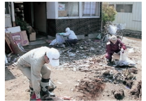
写真4-27 ガレキの撤去と家の片付け 沿岸域では、津波堆積物と呼ばれる、潮水を含んだ土砂がガレキに付着していた。この土砂は性質上粘着力が強く、土砂除去は容易でなかった。 〔4月29日 市社会福祉協議会提供〕
