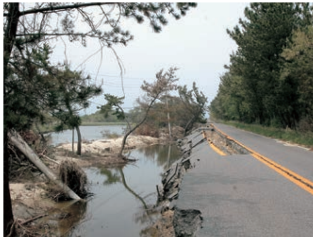
写真4-56 県道四倉－豊間線 藤間沼側が大きく崩れた。〔6月5日 いわき市撮影〕
